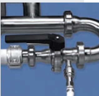
Всасывающий шланг контейнера, подсоединенный к линии CIP
